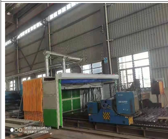
废气处理设施
