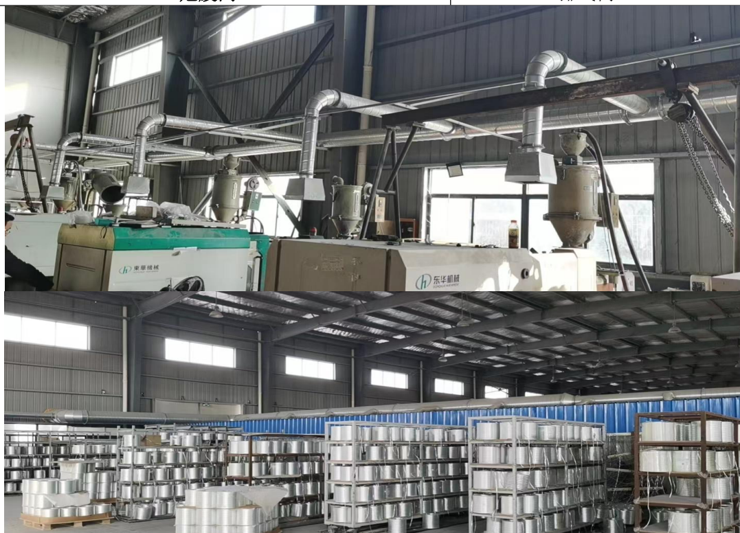
废气收集管道
